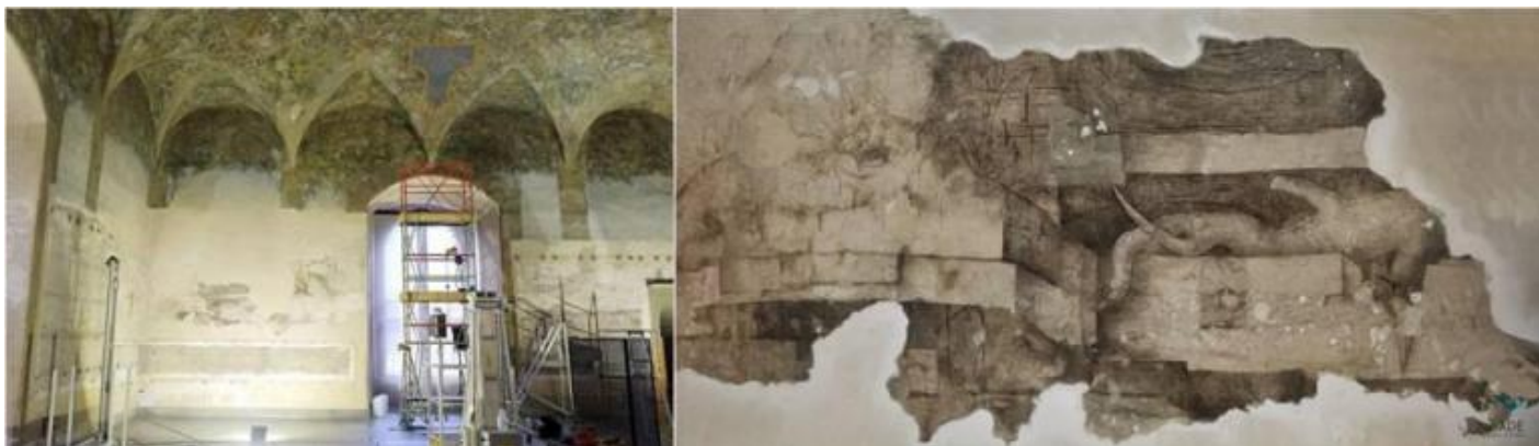
Milano, Castello sforzesco, Sala delle Asse. A sinistra: i lavori di restauro ai monocromi leonardeschi delle pareti. A destra: dettaglio.
