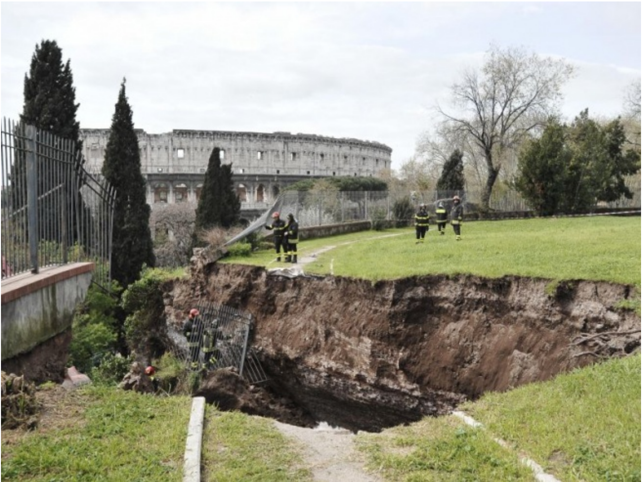
Domus Aurea, crollo del 2010
